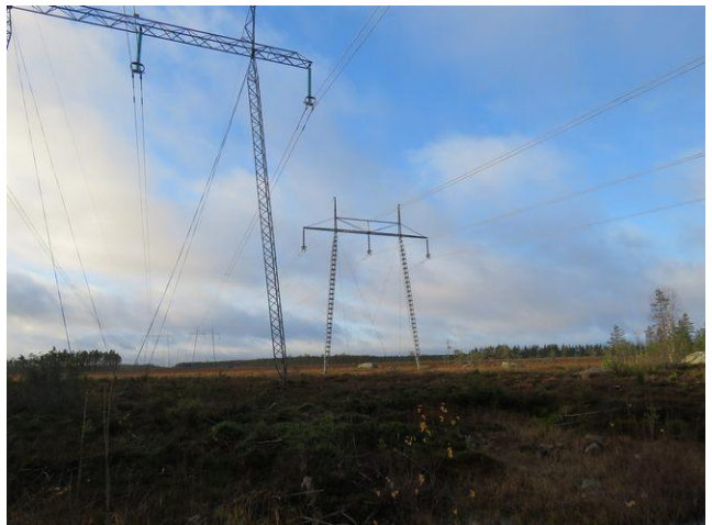
Kuva 4. Voimalinja Ahvenlamminnevan kohdalla hankealueen pohjoispuolella, etelälöinaaseen.
