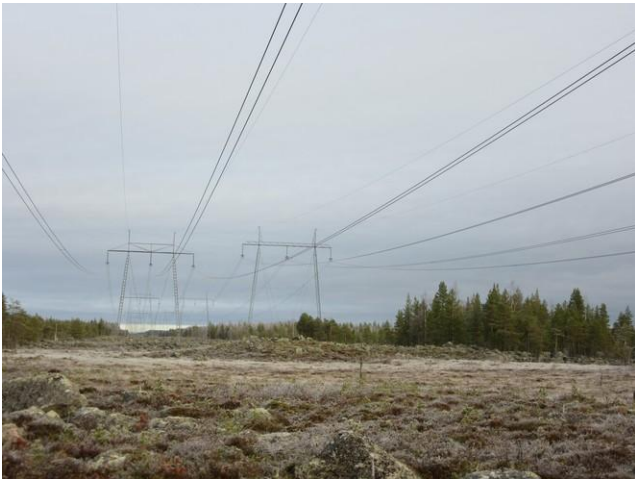
Kuva 44. Voimajohto Katajäärennevan lounaispuolella. Kuvattu lounaaseen.
