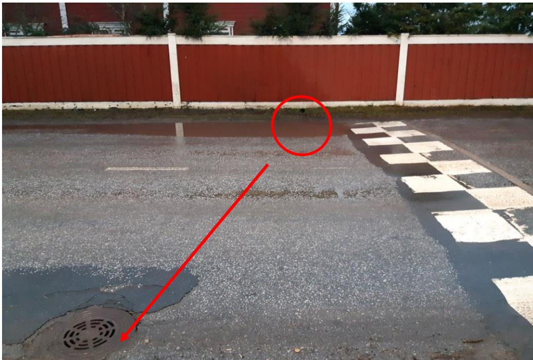
Kuva 2. Pl 1/1850 töyssyn päässä lammikko, joka kastelee aidan. Ilmeisesti kiinteistön omistajan tekemä kuivatusyritys aidan ali ympyröity. Mahdollisen uuden sadevesikaivon purkputken paikka tien alitse.
