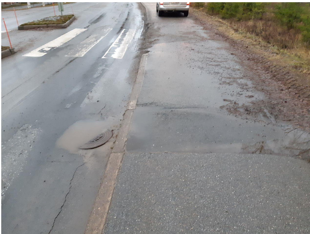
Kuva 5. Pl 2480 sadevesikaivo ja päällystepainuneet. Reunakivi ja kevyenliikenteen väylän päällyste korjattava.
