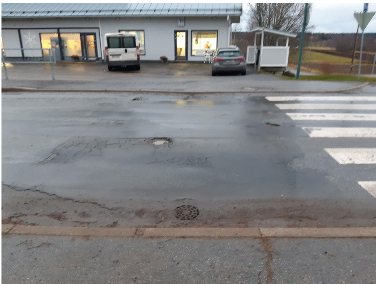
Kuva 4. Pl 1/2320 painumaa ja päällystevaurio.
